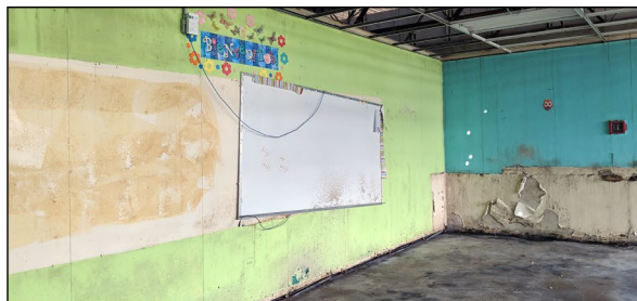
Aula con pisos mohosos y daños por agua en las paredes de una escuela en San Juan, Puerto Rico.
