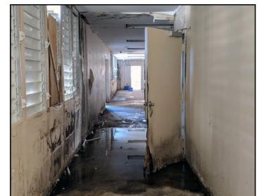
Daños en el interior de una escuela en Puerto Rico por infiltración del agua, con agua estancada y paredes mohosas.
